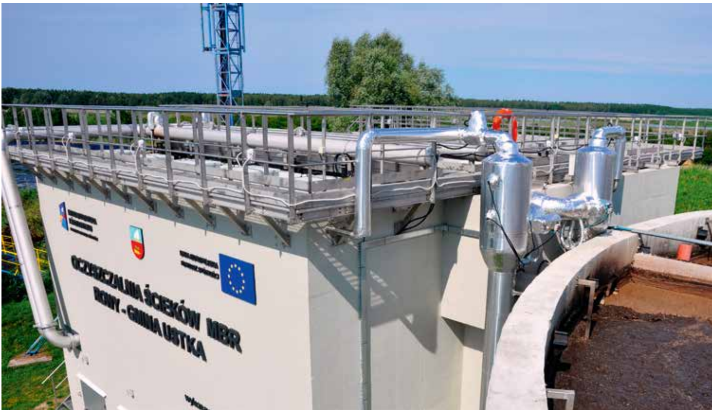
Fot.1. Zbiornik MBR - widok z reaktora biologicznego
