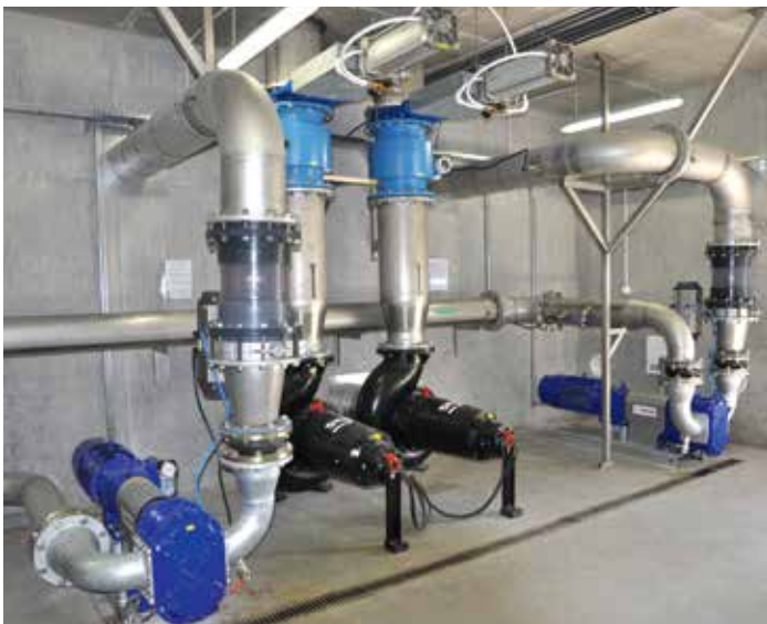
Fot. 2. Pompy permeatu i recykulacji osadu
